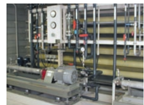
回収水の再生逆浸透膜装置
