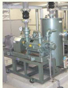
水を循環利用する真空ポンプ
