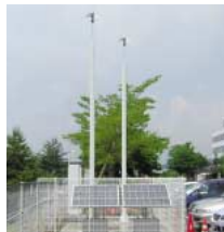
ハイブリッド発電システム
