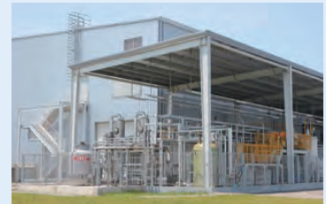
総合系排水処理設備
