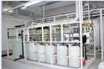
RO※1 水処理室
