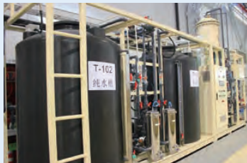
純水製造装置
