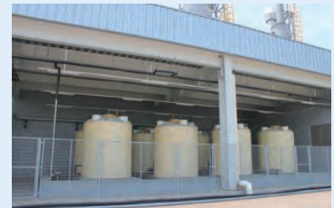
薬液貯蔵設備
