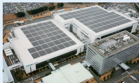
合志事業所に設置した太陽光パネル
