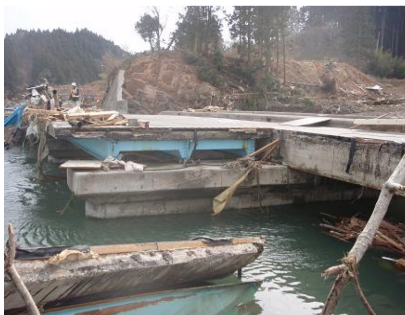
▲水尻橋(上部工及び橋台背面盛土流出)
