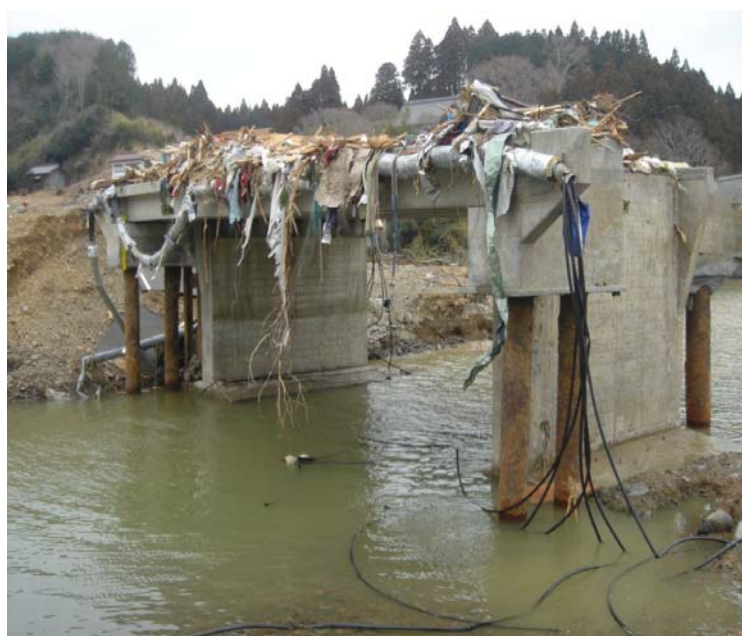
▲ 二十一浜橋(橋台背面盛土流出)
