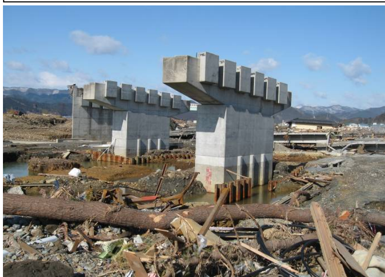
▲沼田跨線橋(上部工流出)
