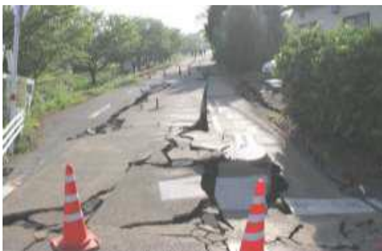
図表：被災した道路（宮園地区）
