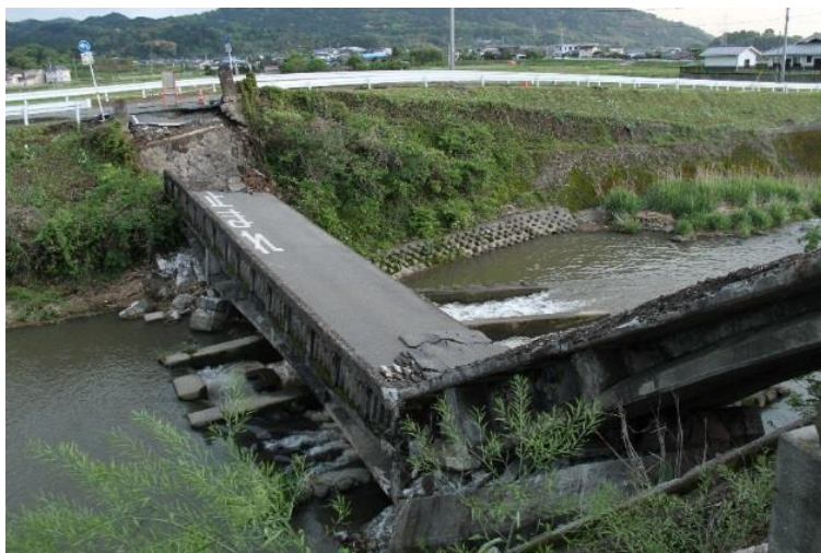
図表：崩落した橋梁（福原地区）
