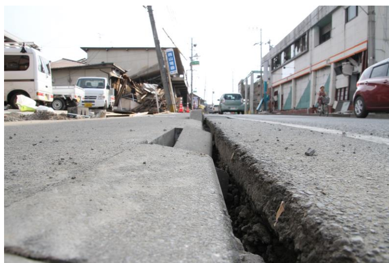
図表：亀裂の入った道路（安永地区）
