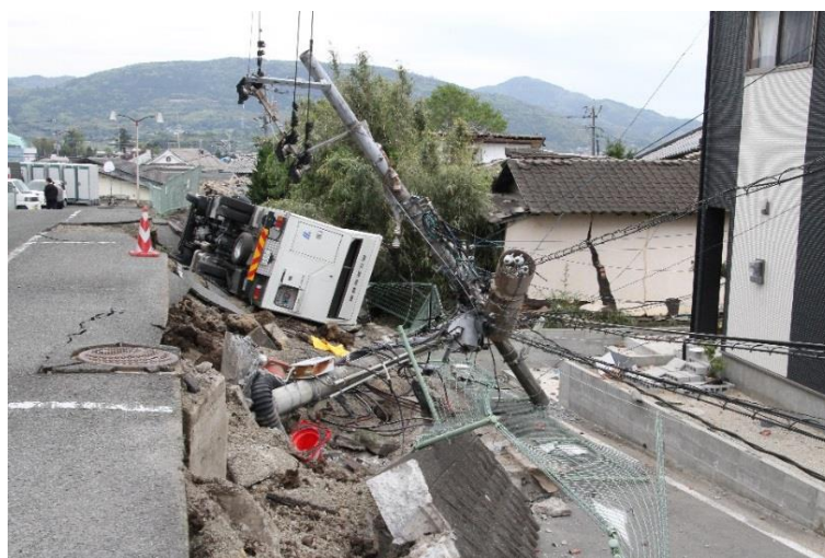
図表：本震により横転した電源車（益城町役場西側）
