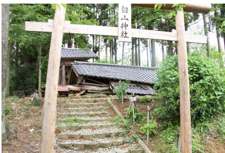
図表：倒壊した神社（飯田地区）
