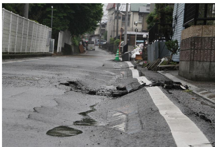
図表：損壊した道路（広崎地区）
