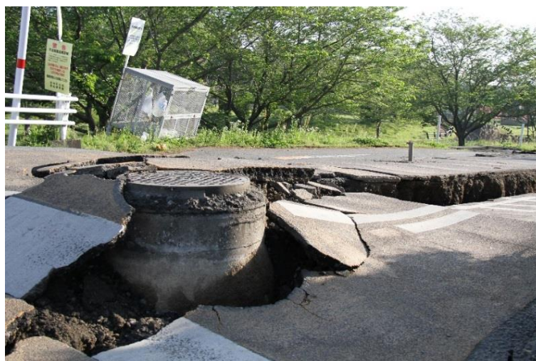
図表：道路の液状化により浮き上がったマンホール（宮園地区）
