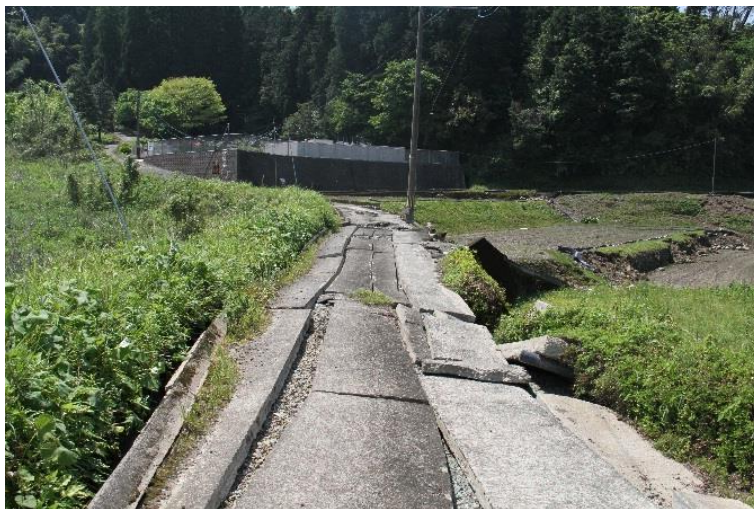
図表：地震により亀裂の入った農道（杉堂地区）
