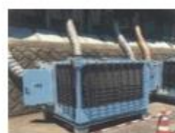
エアコン(室外機)
