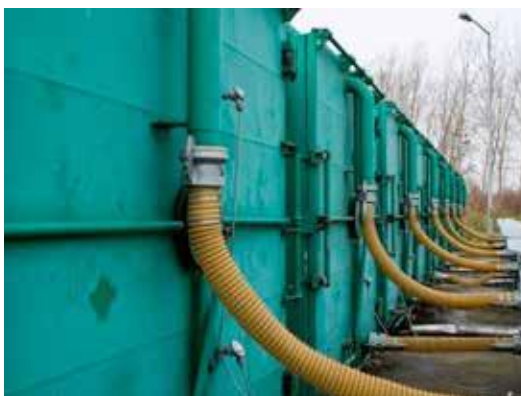
Fot. 3) Kontenery kompostujące z ujęciem powietrza odlotowego i odcieków.
