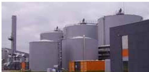
Fot. 1) Średnie instalacje beztlenowej („mokrej”) fermentacji odpadów w Lubece
